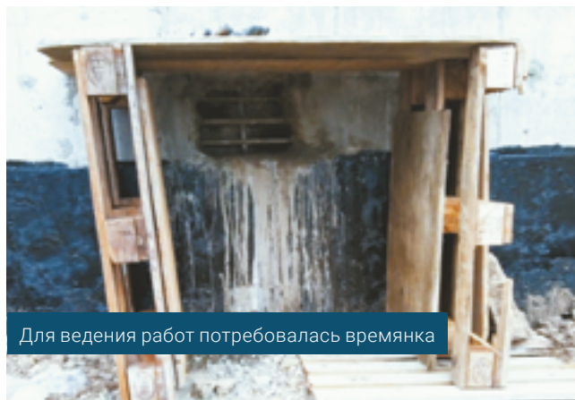
Из-за изъянов бетонирования ввод объекта был под угрозой
